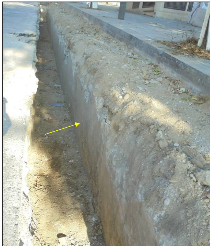
Fotografia 18: Prisma de formigó que protegeix un altre servei, a tocar de la rasa de Via Favència.
